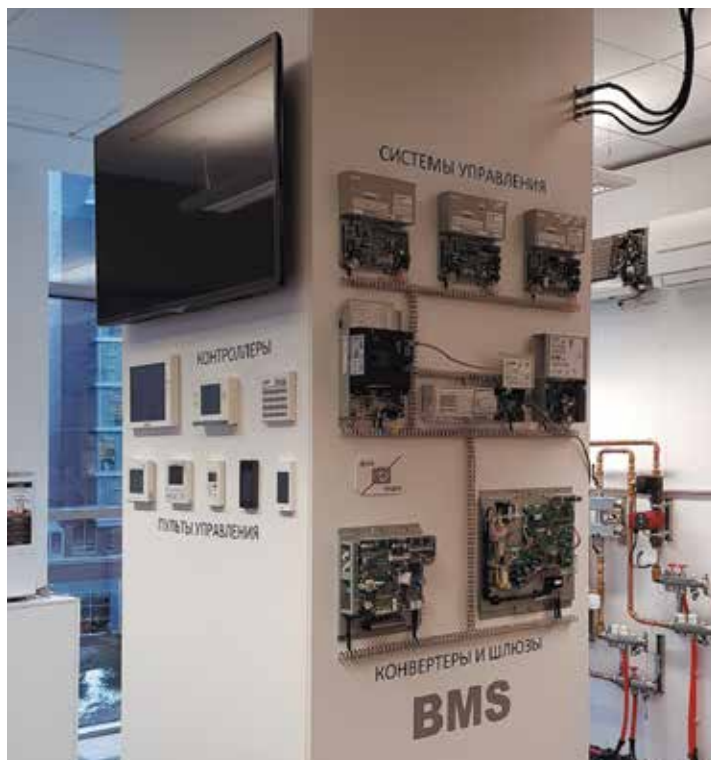
СИСТЕМЫ УПРАВЛЕНИЯ И ШЛЮЗЫ
